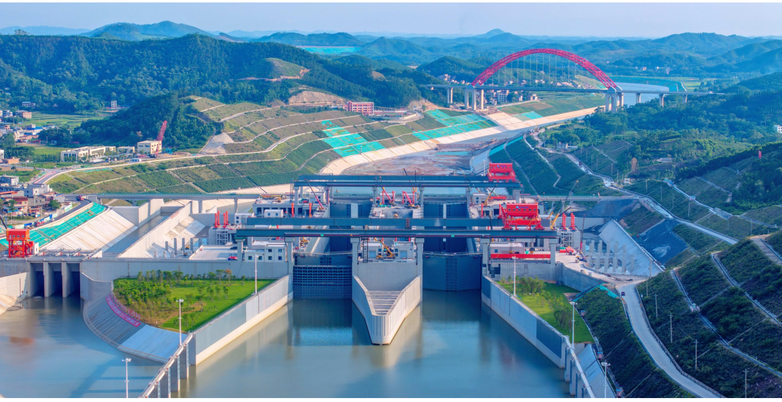
这是6月3日拍摄的广西平陆运河马道枢纽充水现场(无人机照片)。6月3日,随着平陆运河马道枢纽和企石枢纽正式开始充水,平陆运河全线通水,全面进入有水调试阶段。平陆运河是西部陆海新通道骨干工程,全长134.2公里,北起广西横州市平塘江口,经灵山县陆屋镇,沿钦江进入北部湾,作为新中国成立以来我国第一条国家层面统筹的通江达海的运河工程,平陆运河可通航5000吨级船舶,将于今年9月通航。新华社(发(赵振宇)摄)
