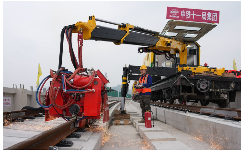
3月22日,在杭州至德清市域铁路施工现场,中铁十一局技术人员操作新能源多场景闪光焊机开展焊接作业。
