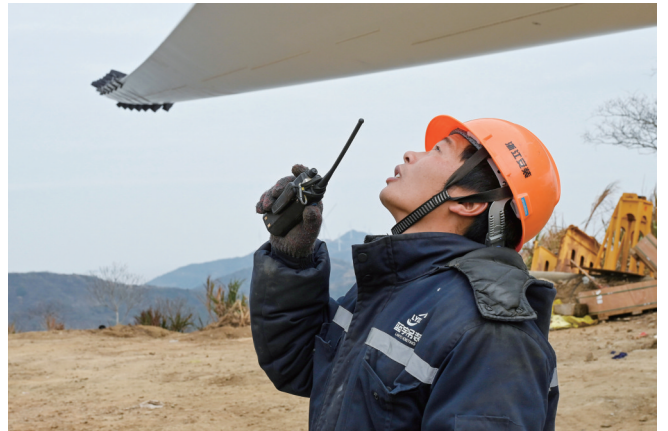
一位负责安装的建设者手持对讲机进行指挥协调，神情专注
