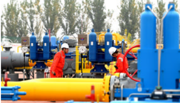
11月12日,永清联络压气站的工作人员在厂区内巡检。
