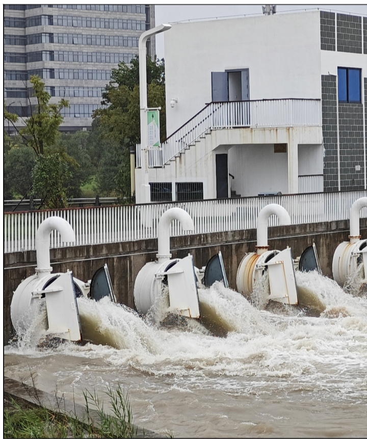
新城田螺峙强排泵站,4根直径为1.6米的泵站出水管强制排水 记者 陈永建 张磊 摄
