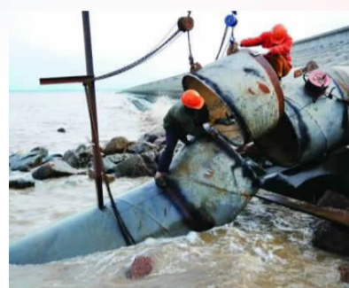
2011年10月，我市大陆引水二期工程海上管道成功登陆宁波镇海
