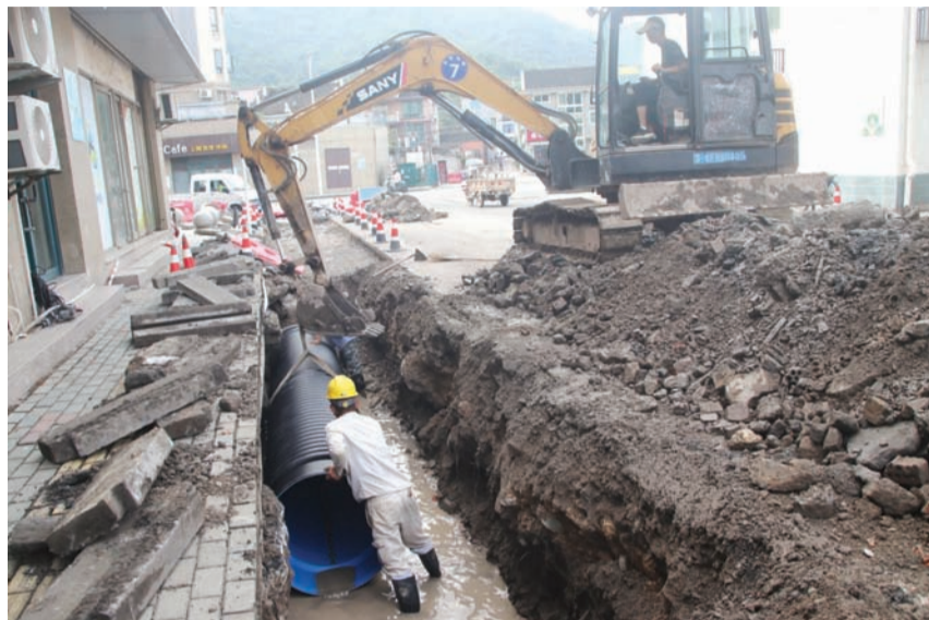
连日来，施工单位全力做好普陀区六横镇蛟头、台门、龙山城区的雨污水管网提升改造工程建设。工程完工并投入使用后，将提升蛟头、台门、龙山3个城区雨污水排放处理能力，巩固“五水共治”成果。 通讯员 刘生国 摄
