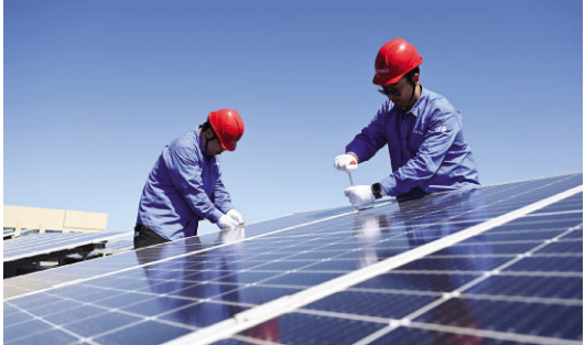
“海力生”产业园区,运维人员检修光伏板 图/姚凯乐
