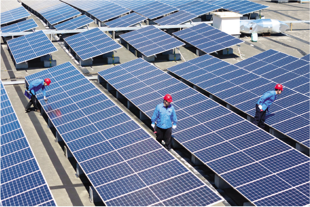
“海力生”产业园区,国网舟山供电公司启明集团运维人员对光伏电站和配电设施开展全面检查 图/姚凯乐
