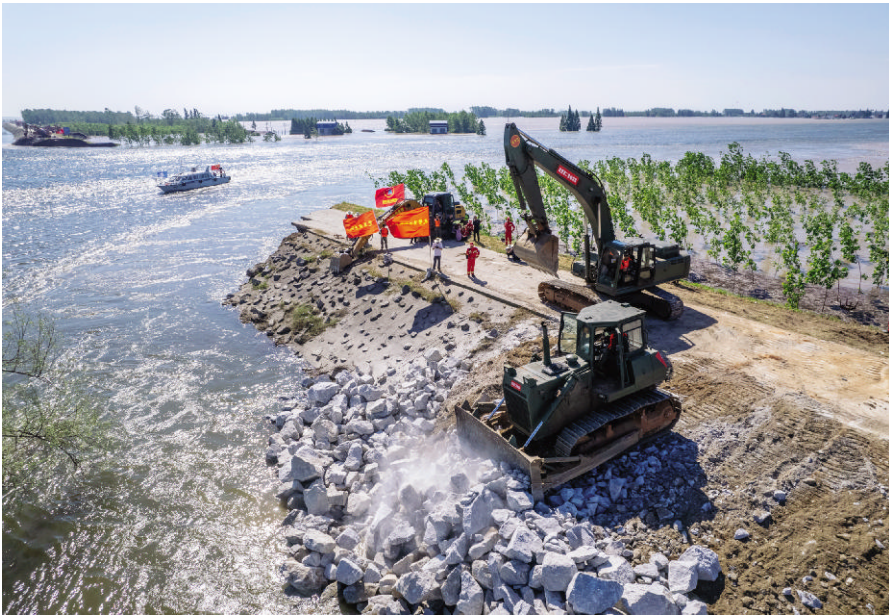
7月6日,湖南省岳阳市华容县团洲垸,抢险人员尝试封堵决口(无人机照片)。
