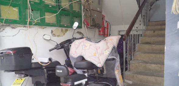
安澜路258号居民楼楼道飞线密布
