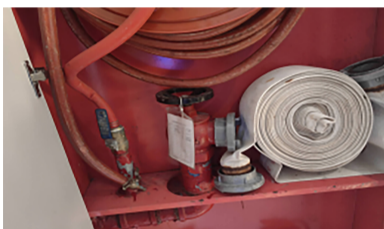
火灾隐患： 三层厨房门口一处消火栓栓口无法与墙面保持垂直
