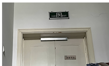
火灾隐患： 疏散指示标志未保存完好有效
