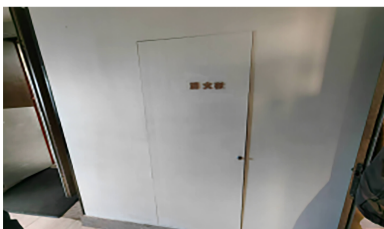
火灾隐患： 部分室内消火栓箱无明显标识
