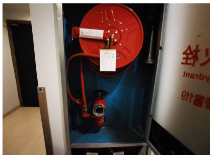
火灾隐患： 该单位地上一层疏散通道上一处室内消火栓消防水带被挪用
