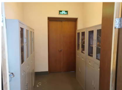
火灾隐患： 该单位地上十一层前室内堆放杂物
