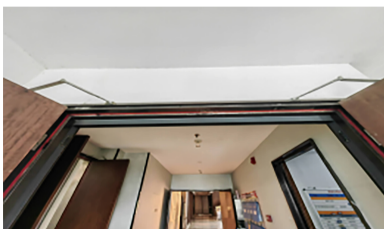
火灾隐患： 两处防火门顺位器未保持完好有效
