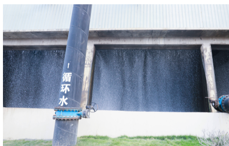
团鸡山生活垃圾焚烧电厂循环水装置
