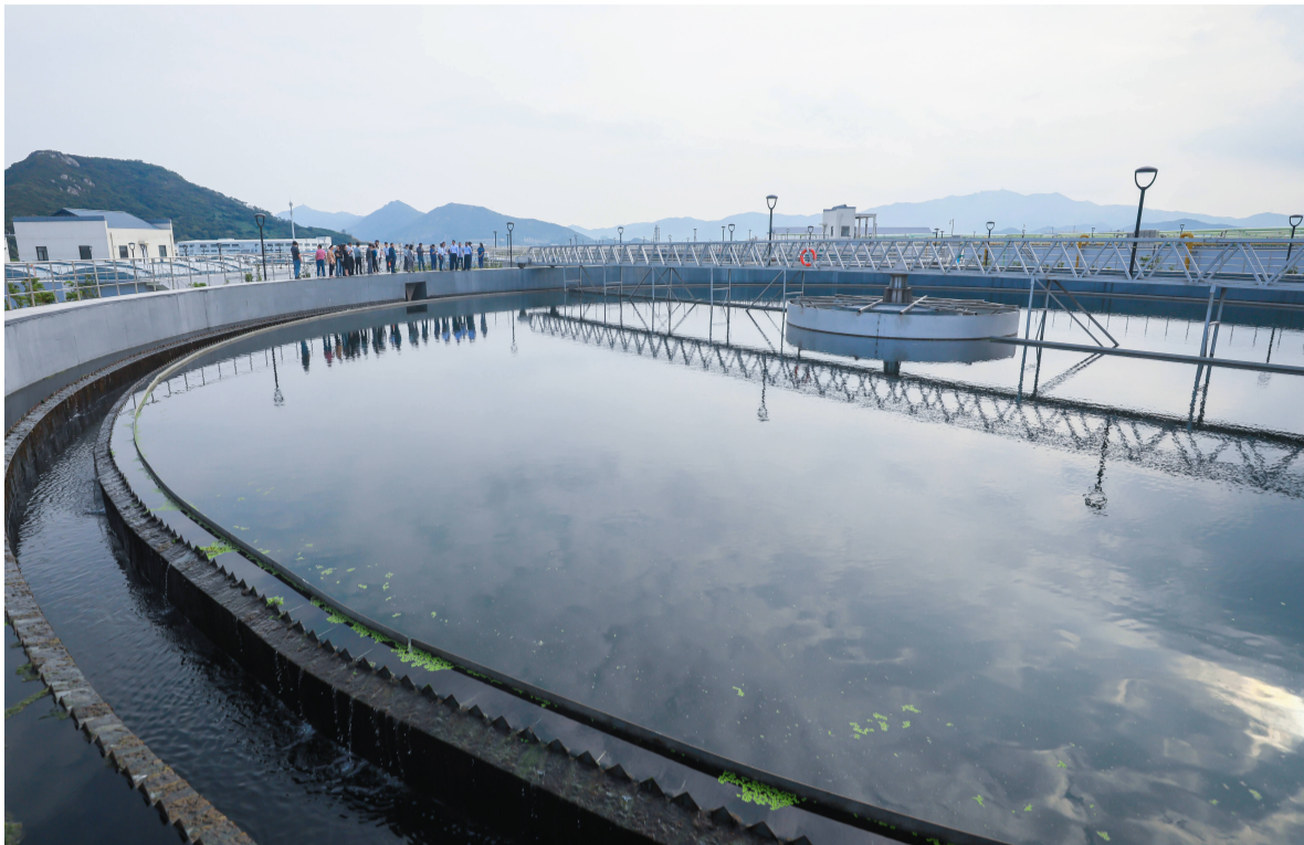
舟山污水处理厂污水处理池
