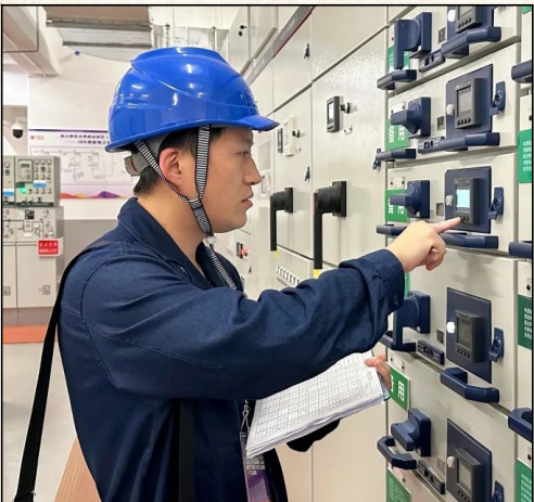
董振凯在亚运手球场馆巡查馆内配电房 图片由受访者提供
