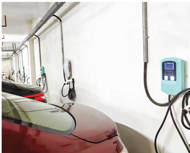
在舟山的一些地下车库,新能源汽车充电设施已经逐渐完备
