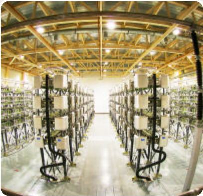
五端柔性直流输电工程柔直阀厅
